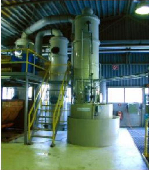
Общий вид установки для расщепления аммиака
