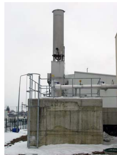
Biogas flare/ Установка для сжигания биогаза
